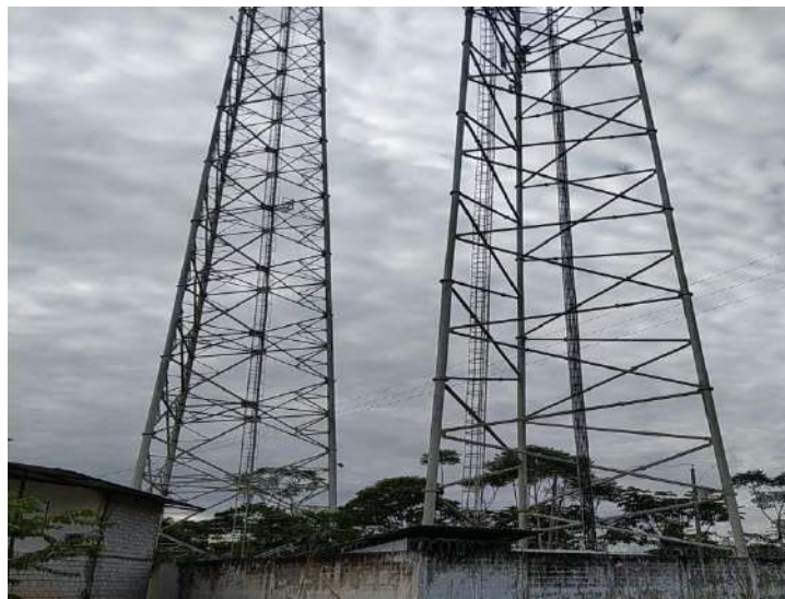
Fotografía 1. Antenas de telefonía móvil
